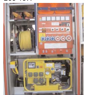
Der tragbare 13kVA-Stromerzeuger.
